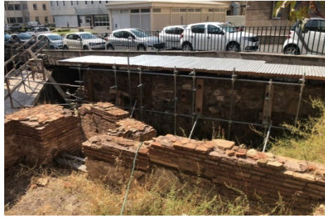
Muro di età basso medievale con puntellatura di messa in sicurezza provvisoria (lato interno)
